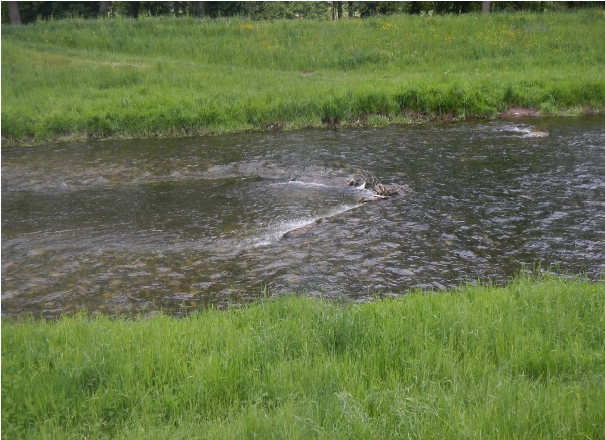
V- Schwelle in der Dreisam mit Auskolkung bis zu einer Tiefe von 60 bis 70 cm
